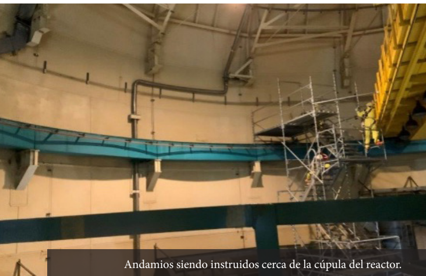
Foto de la cúpula, el revestimiento, las cerchas y el espacio libre para las tuberías.
